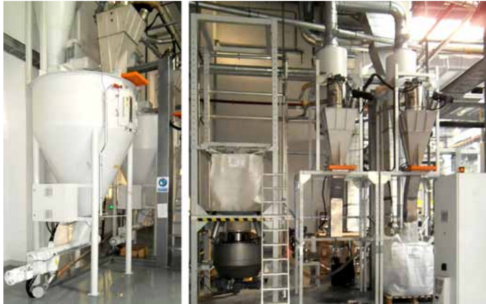
TPO-Mahlguthandling in doppelter Ausführung, getrennt für helle und dunkle Folientypen: Mischtrichter, um unterschiedliche Mahlgutchargen vor dem Zudosieren am Extrudereinzug homogen zu mischen (Bild links) – Entleer- und Befüllstationen für die Big-Bags (rechts).
